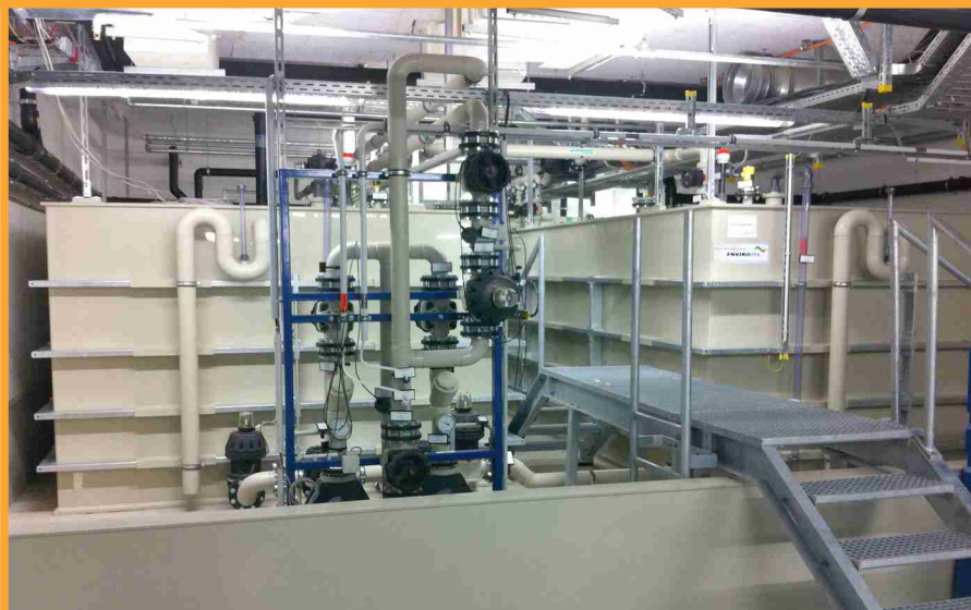
Abwasserkontroll- und Neutralisationsanlage
